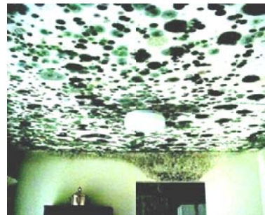
(b) Pada plafon
