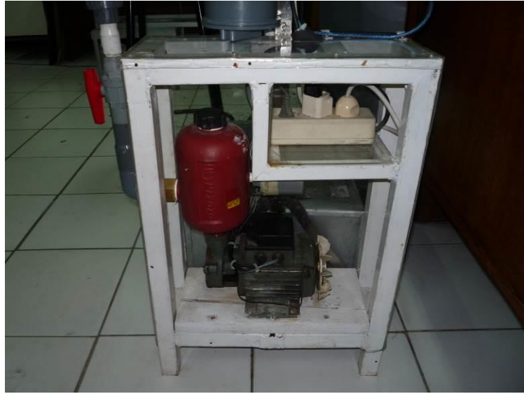
Gambar 3.19. Penempatan pompa air dan stop kontak pada sisi dalam rumah pompa
