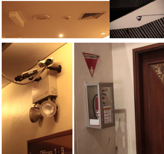
Gambar 4.16 Sistem proteksi kebakaran dan keamanan pada JCC
