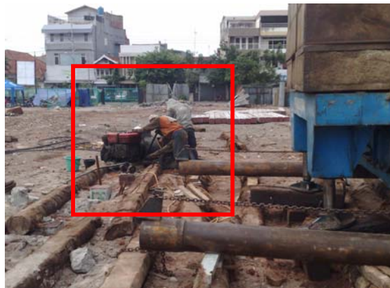
Gambar 4.33. Alat Las Rusak dan Sedang Diperbaiki
