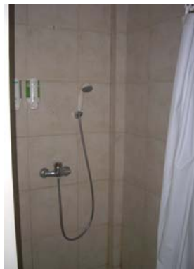
(j) Shower pada setiap ruang
